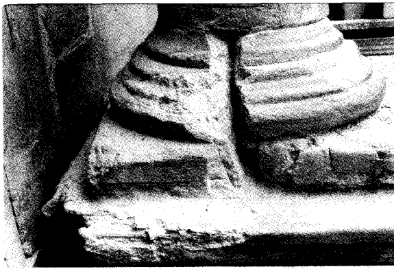
Links oben: Portal, Basis der linken Säule: Zustand nach dem Entfernen der Altergänzungen. Starke substanzielle Schädigungen der Basis.
